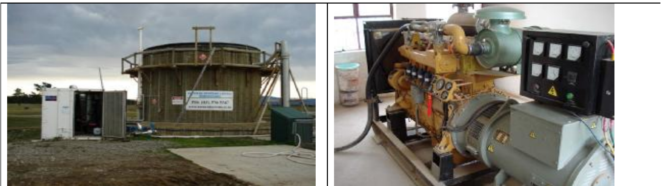
Ảnh 8: Nhà máy sản xuất biogas tại trang trại Ảnh 9: Máy phát điện sử dụng biogas
